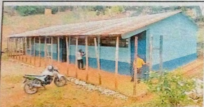
Foto 3: TECHO EN CONDICIONES DE OXIDACIÓN: El techo evidencia la presencia de óxido. (Miembros de OPF realizando mediciones)
