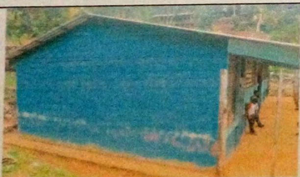
Foto 5: PINTURA: Se observan razgos de humedad en la pared y deterioro de la capa de pintura en el establecimiento educativo.
