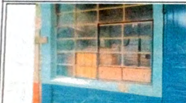
Foto 7: VENTANAS: Algunos vidrios de las ventanas están quebrados.
