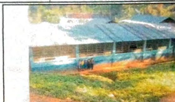
Foto 8: SISTEMA DE CAPTACIÓN DE AGUA: Colapsó el sistema de captación de agua pluvial - Parte trasera del edificio escolar. (niños al fondo)
